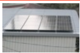
A様 発電所
